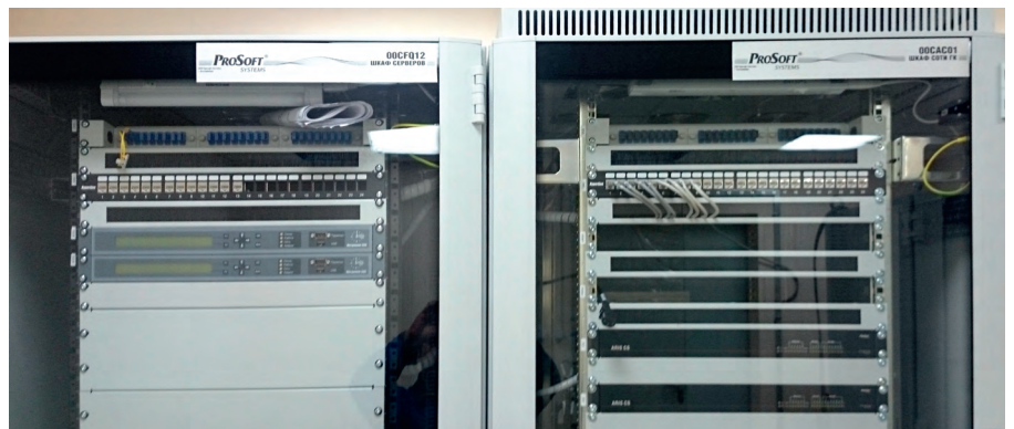
Рис. 5. Основное оборудование СОТИ АССО, шкаф серверов
