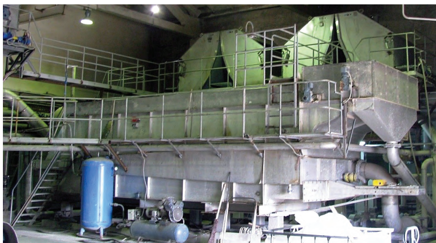
Рис. 1. Флотационная установка МСН 60
