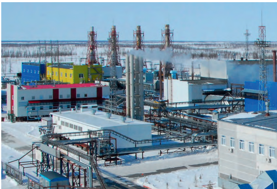
Рис. 1. Газотурбинная электростанция собственных нужд
