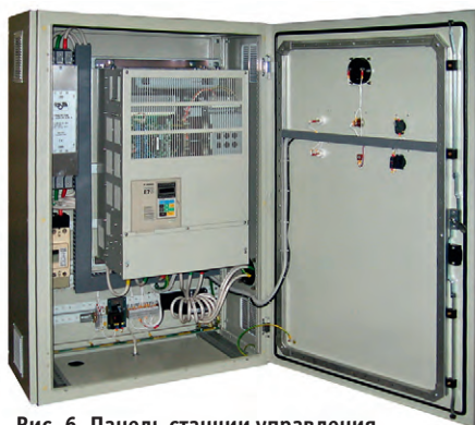
Рис. 6. Панель станции управления питателем ДСФ с открытой дверцей
