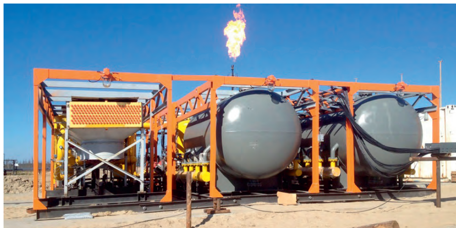
Рис. 1. Общий вид установки по подготовке попутного нефтяного газа
