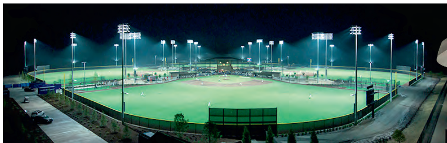
Рис. 11. Освещение стадиона светодиодными прожекторами
