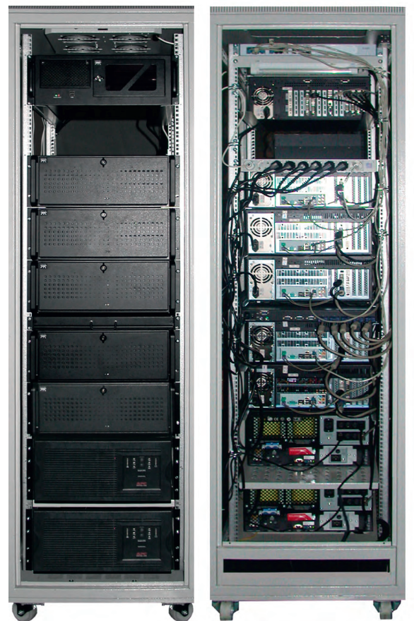
Рис. 4. Шкаф вычислительного комплекса системы визуализации, вид спереди и сзади (двери сняты)
