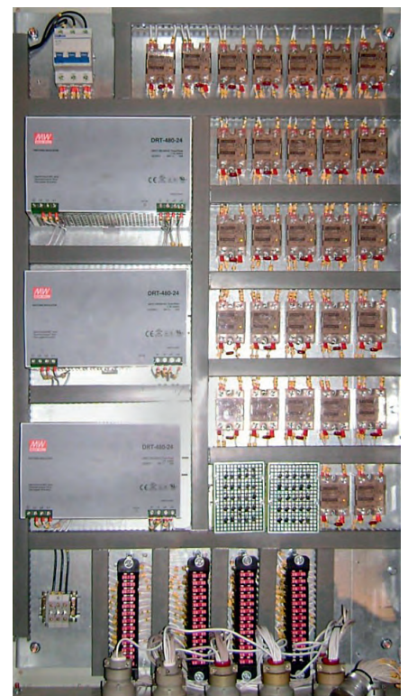
Рис. 5. Блок бесконтактной коммутации панели ПЛК
