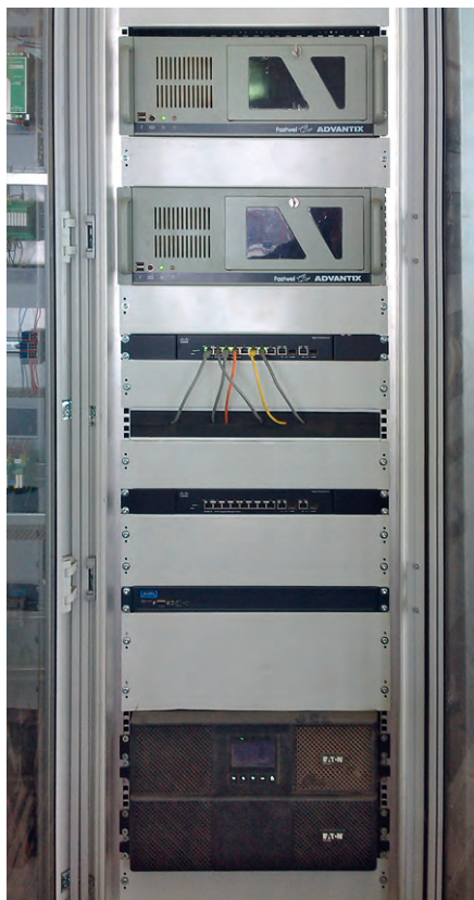
Рис. 16. Внешний вид шкафа управления системы УПСВ
