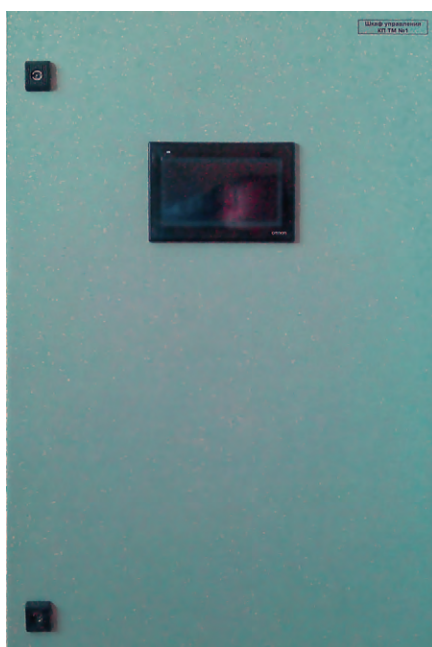
Рис. 5. Внешний вид шкафа телемеханики КПТМ № 1
