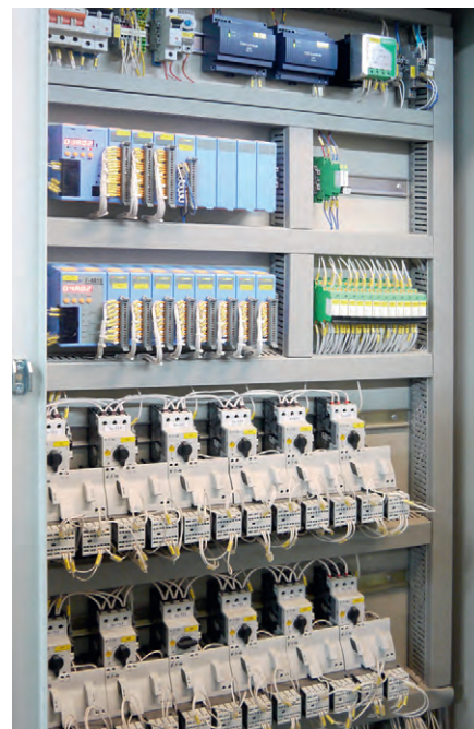
Рис. 6. Шкаф управления электроприводом запорной арматуры
