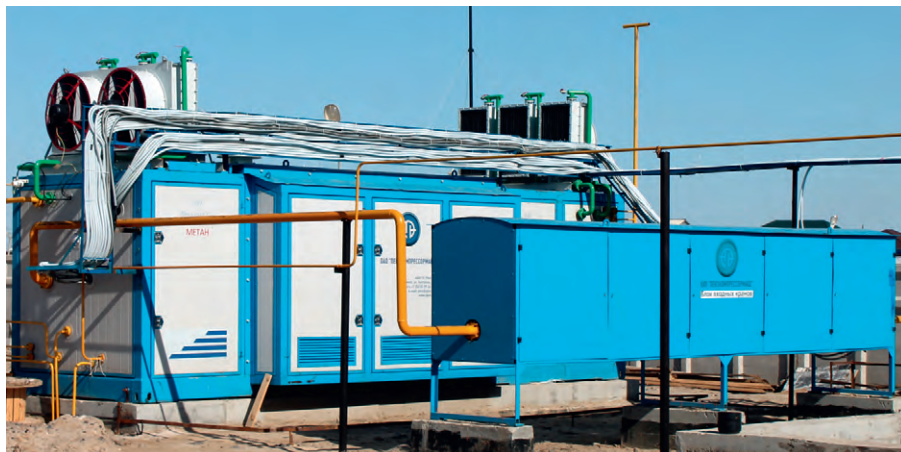
Рис. 8. Компрессорная станция, входящая в состав АГНКС
