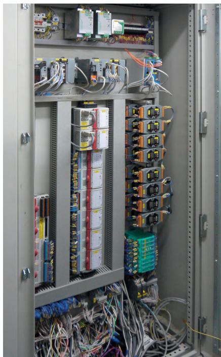
Рис. 4. Шкаф контроллеров РСУ
