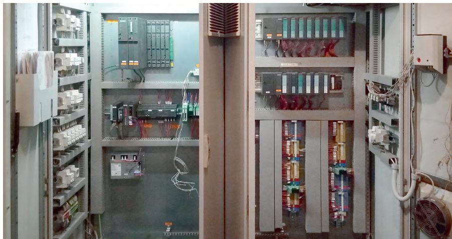
Рис. 4. Шкаф с основным контроллером и контроллером защиты
