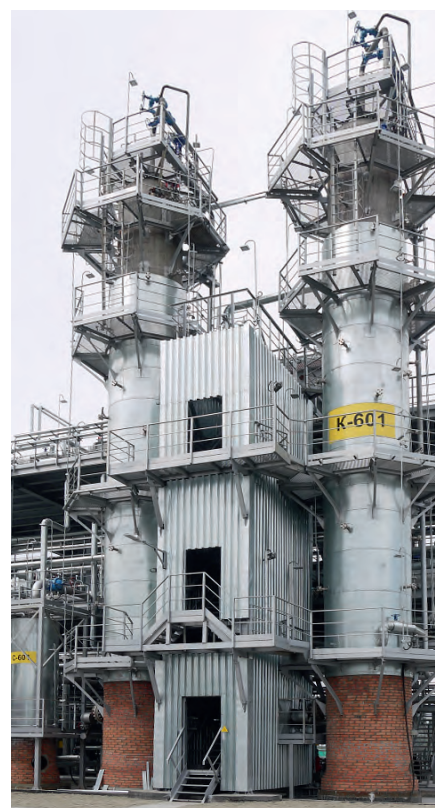
Рис. 2. Колонны окисления гудрона
