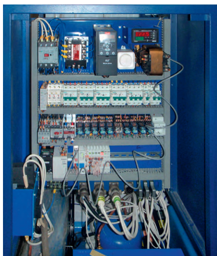
Рис. 3. Шкаф с оборудованием информационно-измерительной системы
