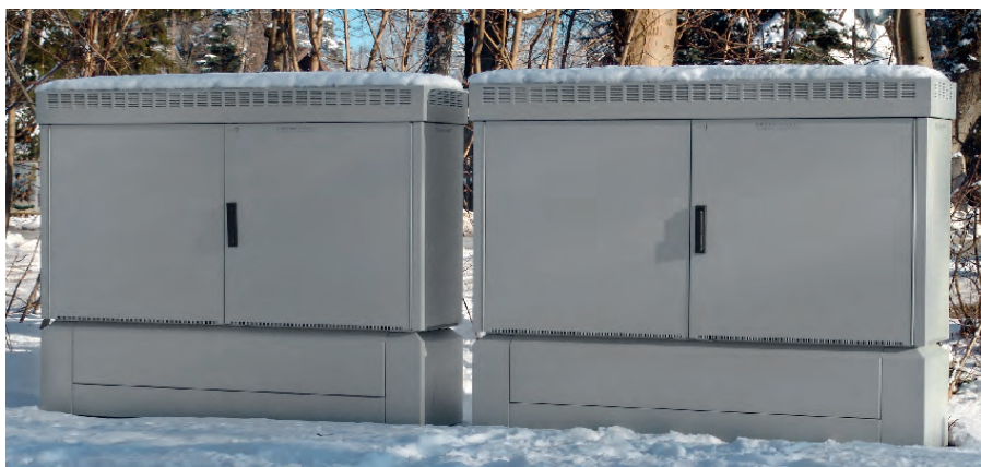
Рис. 5. Шкафы с телекоммуникационным оборудованием
