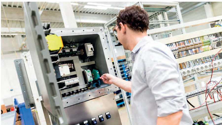
Рис. 13. Взрывозащищённый шкаф с элементами обеспечения безопасности
